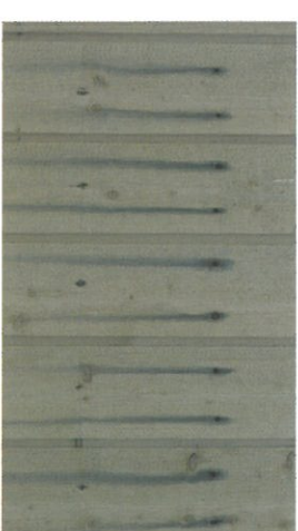
Figur 81 Misfarvning af træbeklædning fra korroderende søm (og skrue).
